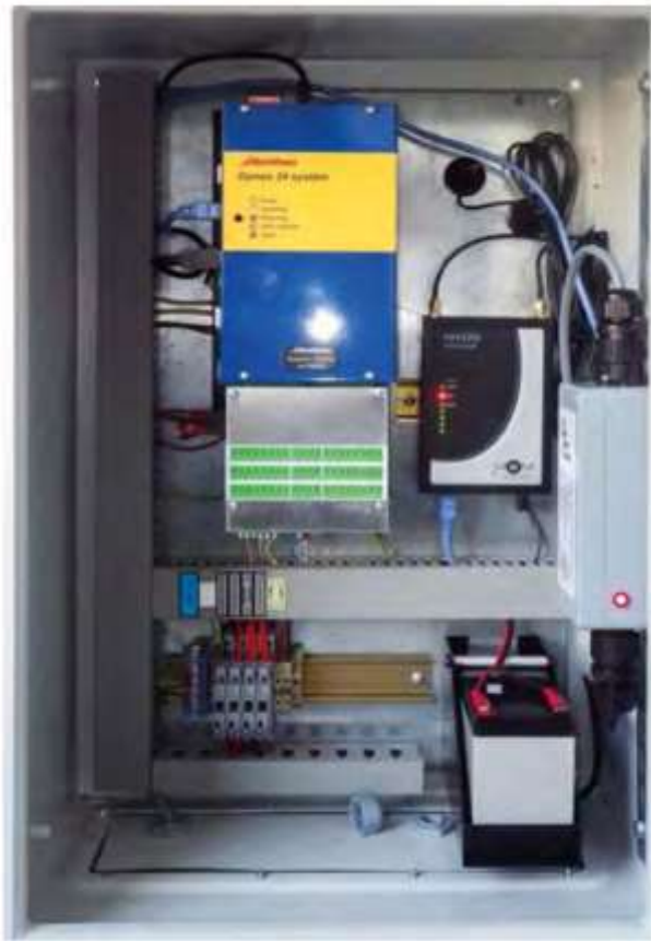
شکل ۳۴ تصویری از تابلو برق موجود در یکی ایستگاه‌های شتابنگاری کشور ایتالیا
