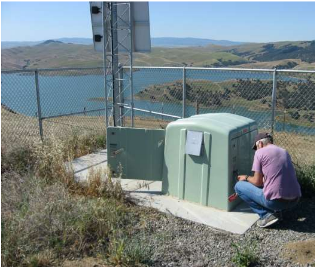
شکل ۳۹ نمونه اجرایی ایستگاه شتابنگاری
