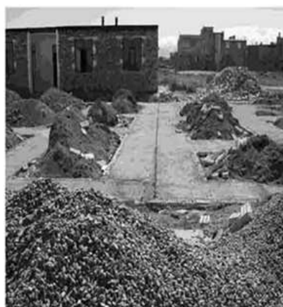
ریختن خاک و نخاله ساختمانی در قسمتهای خارجی قالبهای فونداسیون و عدم اجرا بلوکاز
