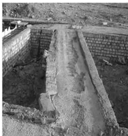
خالی بودن پشت دیواره قالب موقع بتن ریزی و حرکت دیواره قالب و در نتیجه آسیب هندسه فونداسیون بتنی
